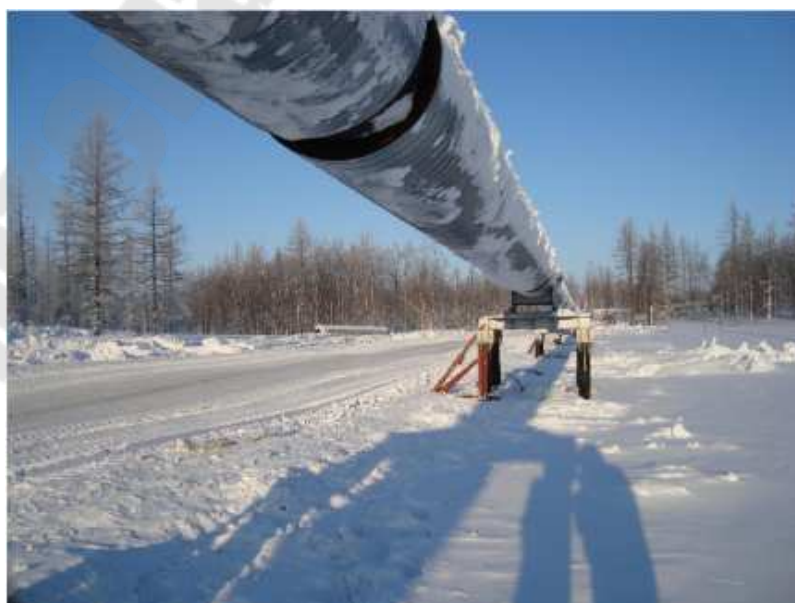
Рисунок 2.20 – Надземная прокладка нефтепровода
