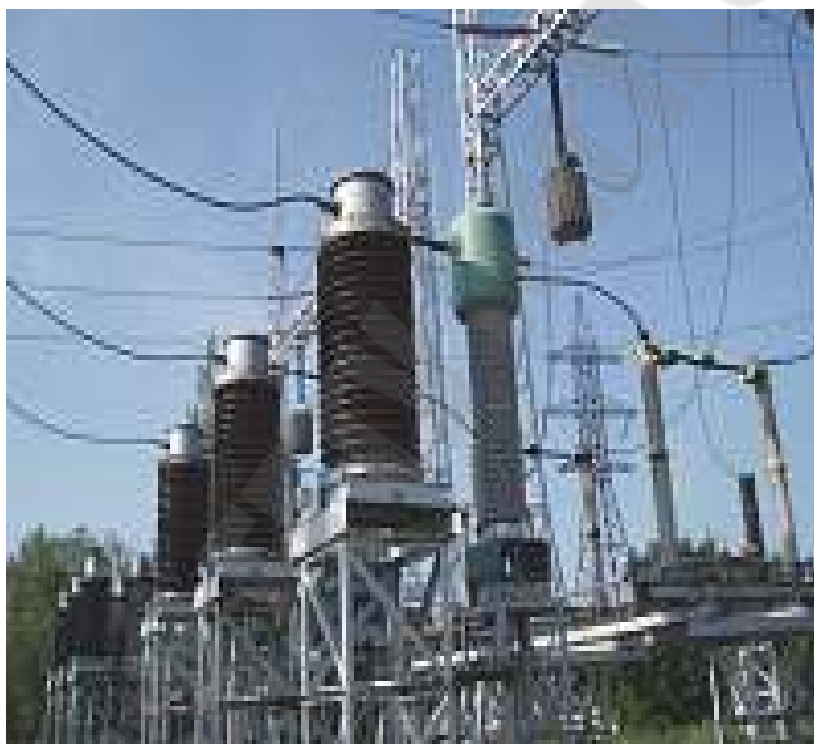
Рис.8 Трансформатор тока типа ТФН-110
