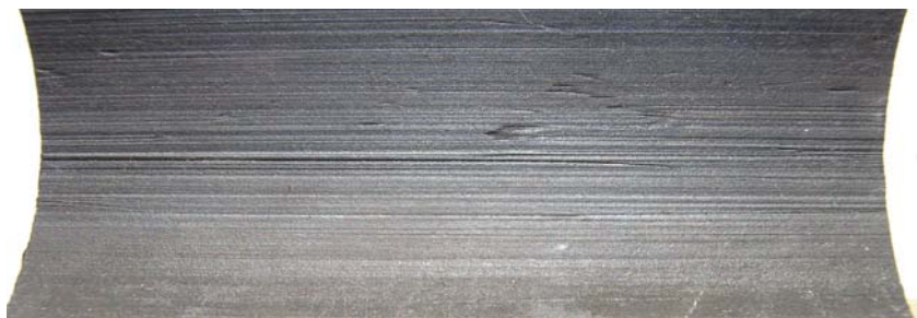
Рис. 1. Внешний вид дефектов на внутренней поверхности трубы
