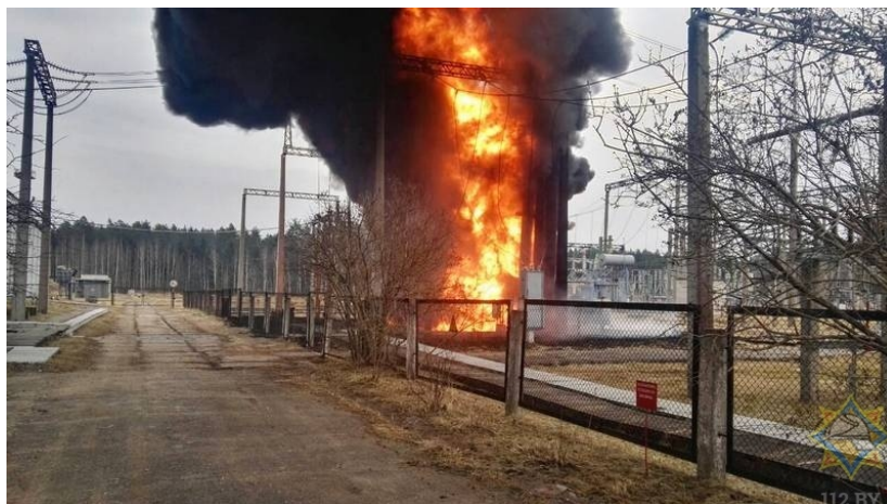
Рис. 2. Возгорание трансформатора под воздействием электрической дуги внутри бака трансформатора
