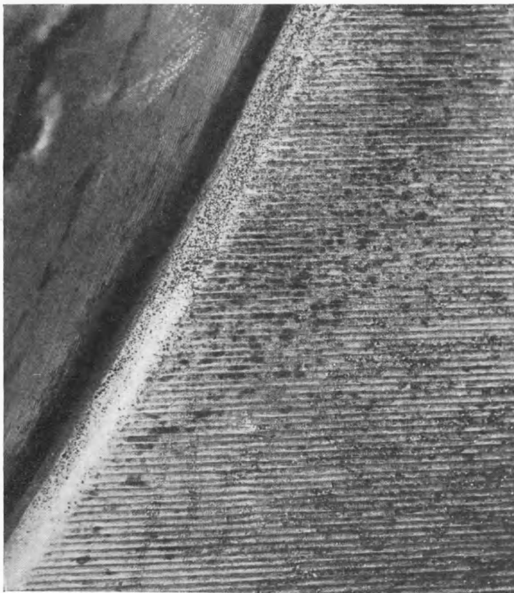
Рис. 1. Эрозия поверхности чугушной втулки рабочего колеса поворотной-лопастной турбины
