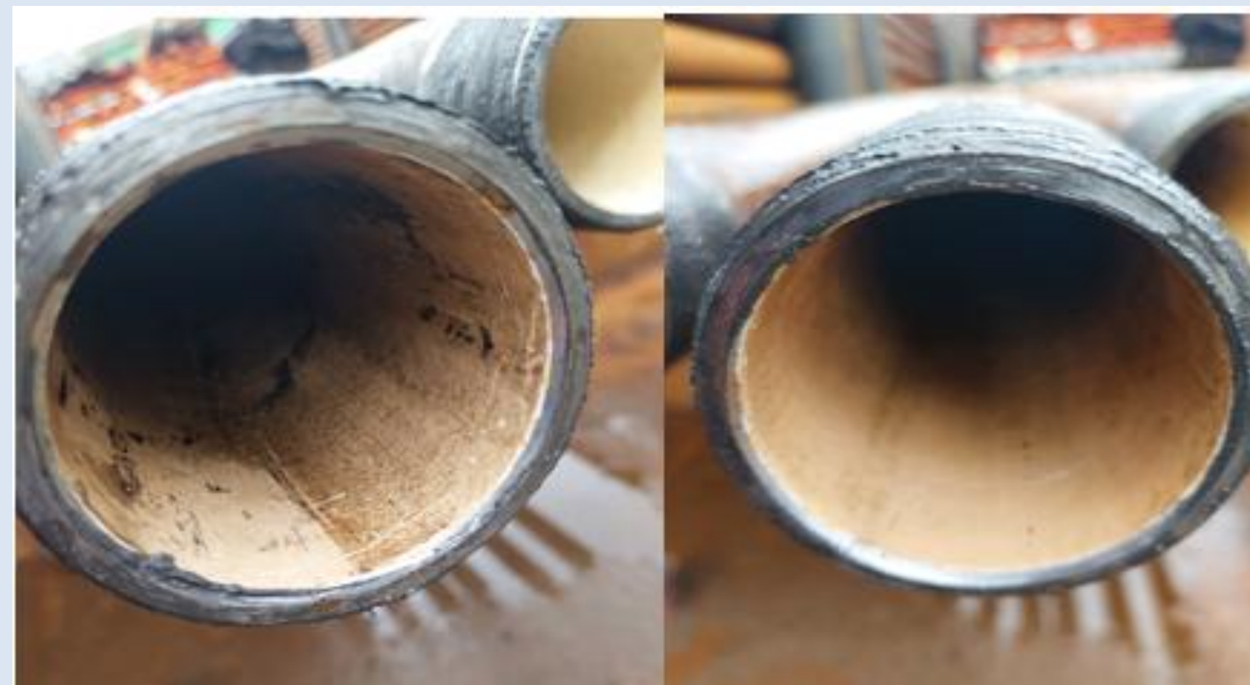
Рисунок 1 – Состояние покрытия MPLAG17 после проведения среднего ремонта
