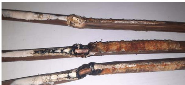
Рис. 2. Изолированные жилы кабеля при снижении сопротивления изоляции в районе сродки с кабельным удлинителем УЭЦН
