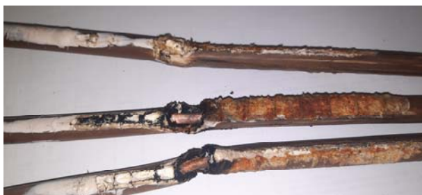
Рис. 2. Изолированные жилы кабеля при снижении сопротивления изоляции в районе сротки с кабельным удлинителем УЭЦН
