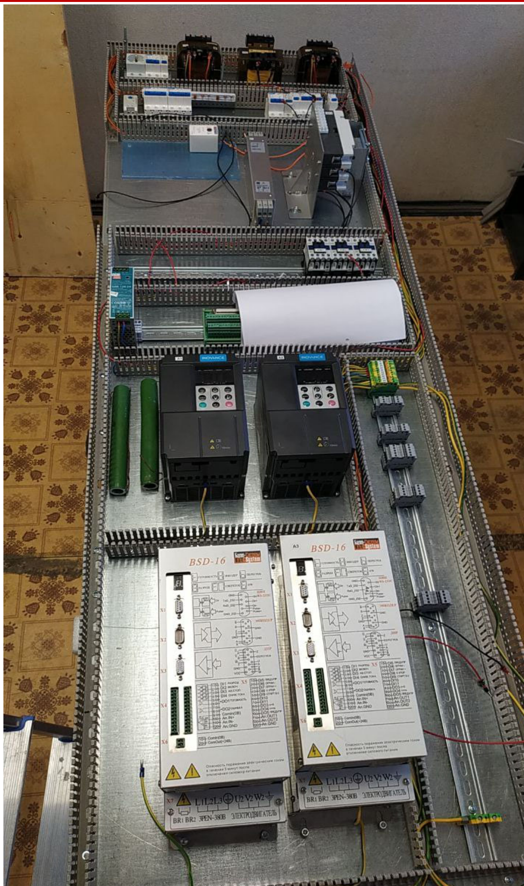
Рис. 3. Установка новой электрической части станка «Асфероид-100»
