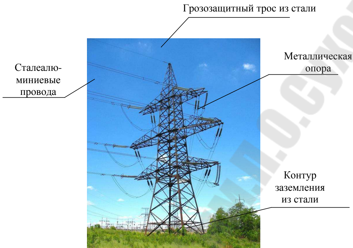
Рис. 14.8. Опора высоковольтной линии электропередачи
