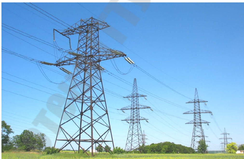
Рис. 1.1. Высоковольтная воздушная линия электропередачи
