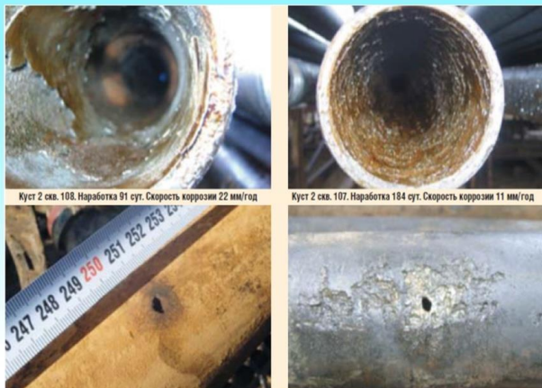
Рисунок 1 — Коррозия НКТ на скважинах
