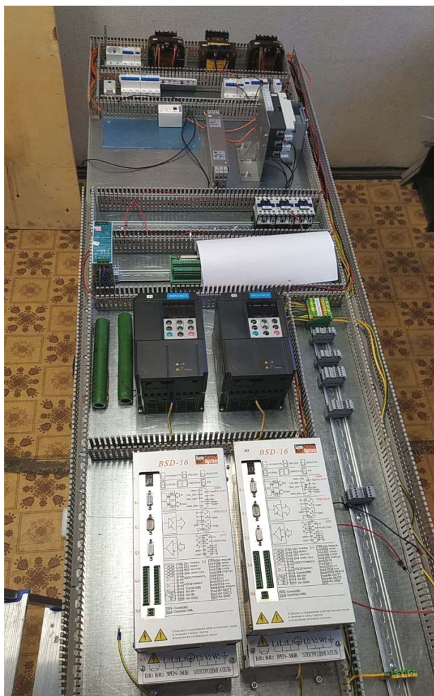
Рис. 3. Новая монтажная панель шкафа управления станка «Асфероид-100»
