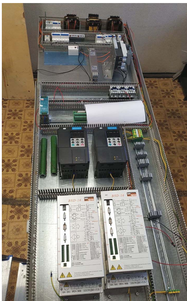
Рис. 3. Новая монтажная панель шкафа управления станка «Асфероид-100»
