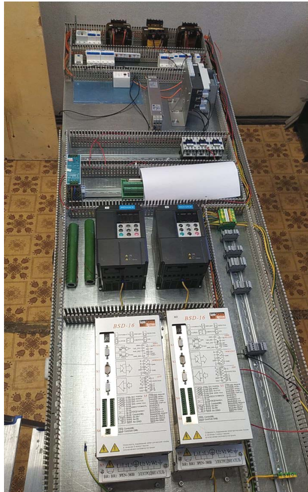
Рис. 3. Новая монтажная панель шкафа управления станка «Асфероид-100»
