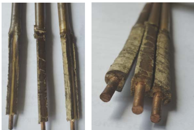
Рис. 3. Жилы основного кабеля с дефектной изоляцией
