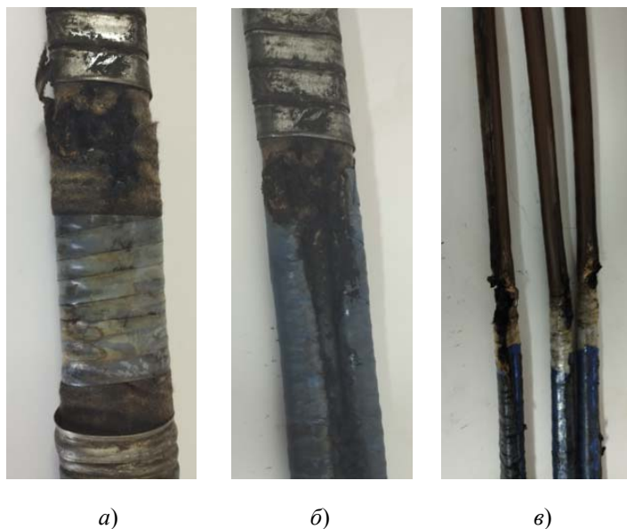
Рис. 1. Фрагмент соединительной муфты со следами повреждения (в виде прогара): а – на подушке кабеля после удаления части брони; б – на жилой изоляции после удаления подушки и подмотки фторопластовой лентой; в – на отдельных жилах кабеля после полного демонтажа муфты
