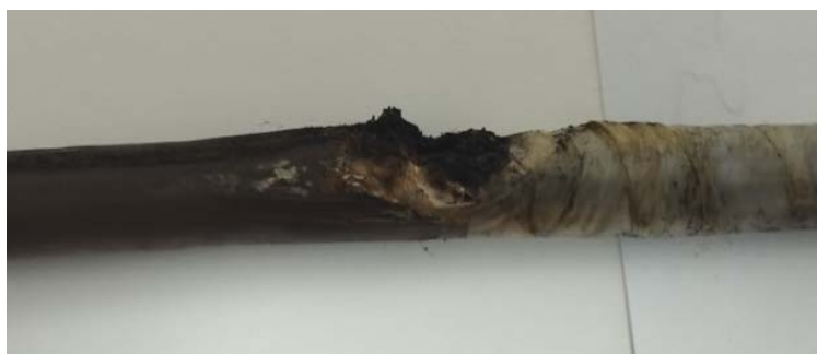
Рис. 2. Жила основного кабеля со следами прогара изоляции после демонтажа муфты
