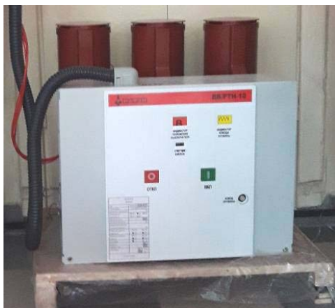
Рис. 1. Высоковольтный выключатель ВВ/РТН-10
