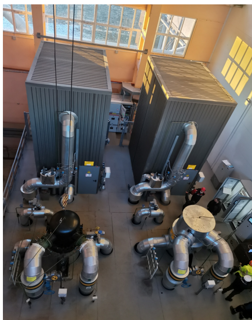
Рис. 2. Внешний вид электродкотлов и вспомогательного оборудования
