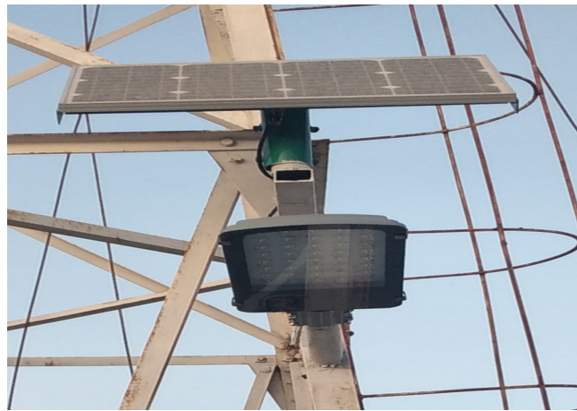
Рис. 1. Уличный светодиодный светильник с номинальной мощностью 60 Вт, установленный на научно-исследовательской площадке ГЭИТ
