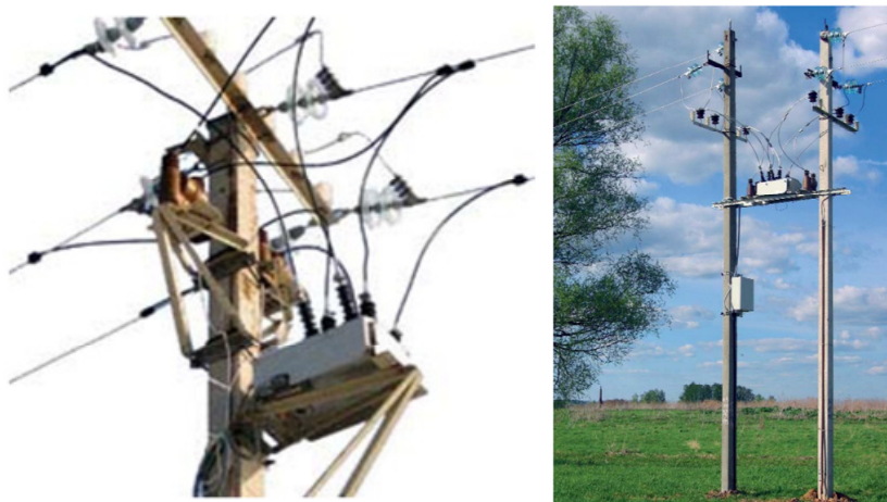
Рис. 1. Вакуумный реклоузер и его крепление на опорах ЛЭП
