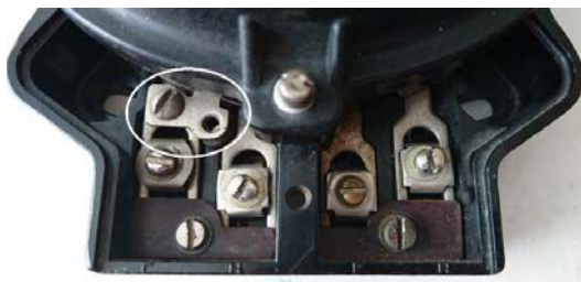
Рис. 2. Отсутствие на счетчике крышки клеммной колодки или пломбы
