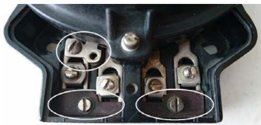
Рис. 3. Хищение электроэнергии с помощью самодельного шунта
