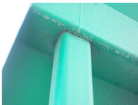
Рис. 1. Неисправность узла соединения стойки с верхним продольным уголком усиления торцевой стены
