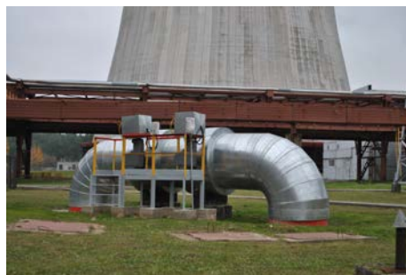
Рис. 9. Перемычка между циркуловодами Fig. 9. The jumper between circulating water pipelines
