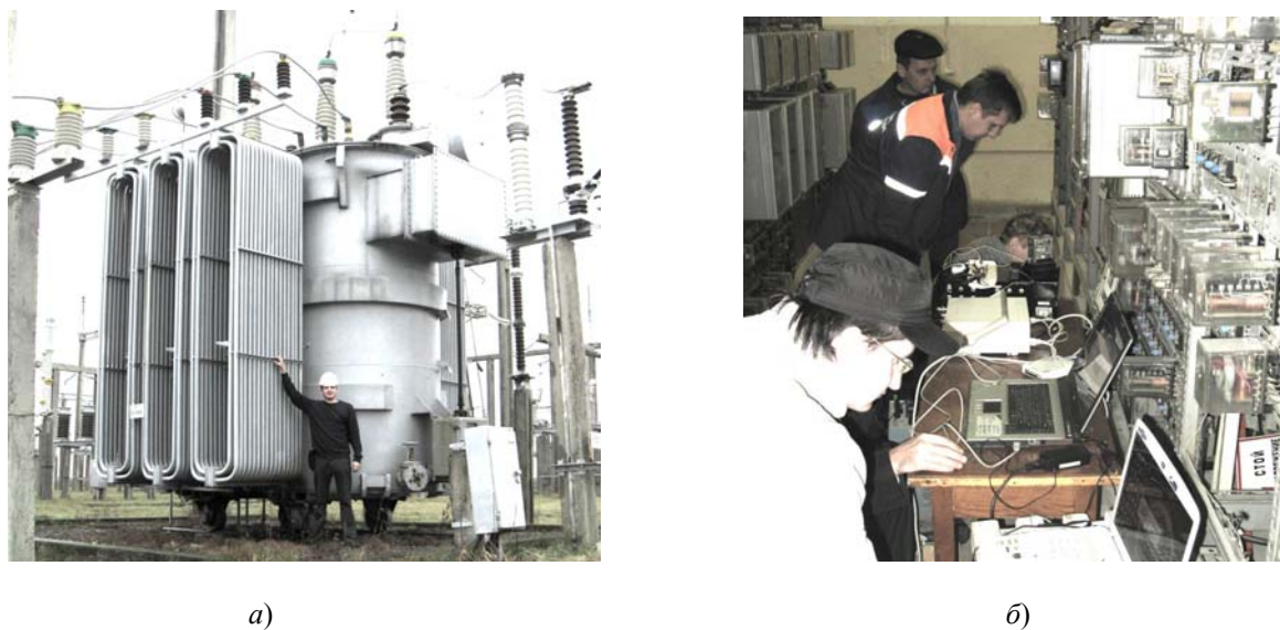
Рис. 1. Объект исследования: а – трансформатор; б – инженеры электрических сетей осуществляют подключение средств измерений в релейном зале подстанции
