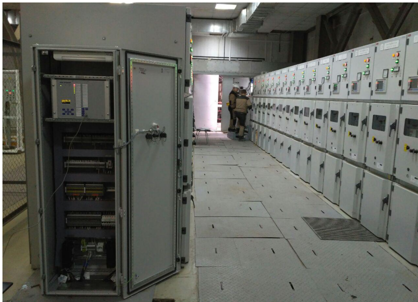
Рис. 4. Шкаф быстродействующей автоматики ввода резерва
