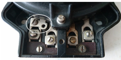
Рисунок 2 – Отсутствие на счётчике крышки клеммной колодки или пломбы
