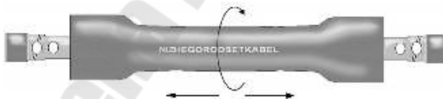
Рис. 10.22. К иллюстрации последовательности работ при монтаже термоусаживающейся муфты (установка внутренней трубы и направление прогрева)
